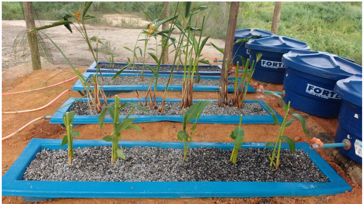
Figura 2 - Sistemas Alagados Construídos em funcionamento.
