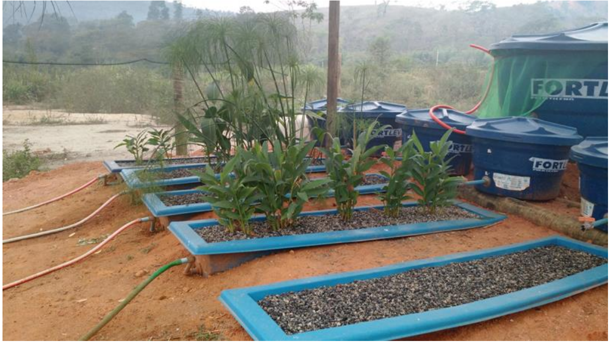
Figura 3 - Sistemas Alagados Construídos em funcionamento.
